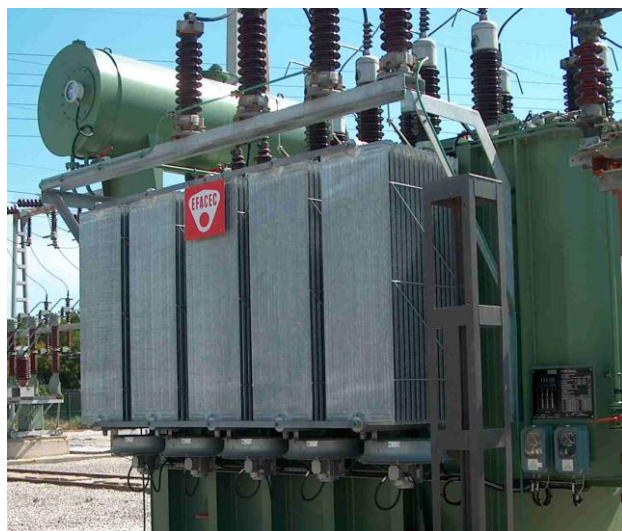
Figura 7.22. Arrefecimento tipo ONAF. Notem-se os ventiladores debaixo dos radiadores.
